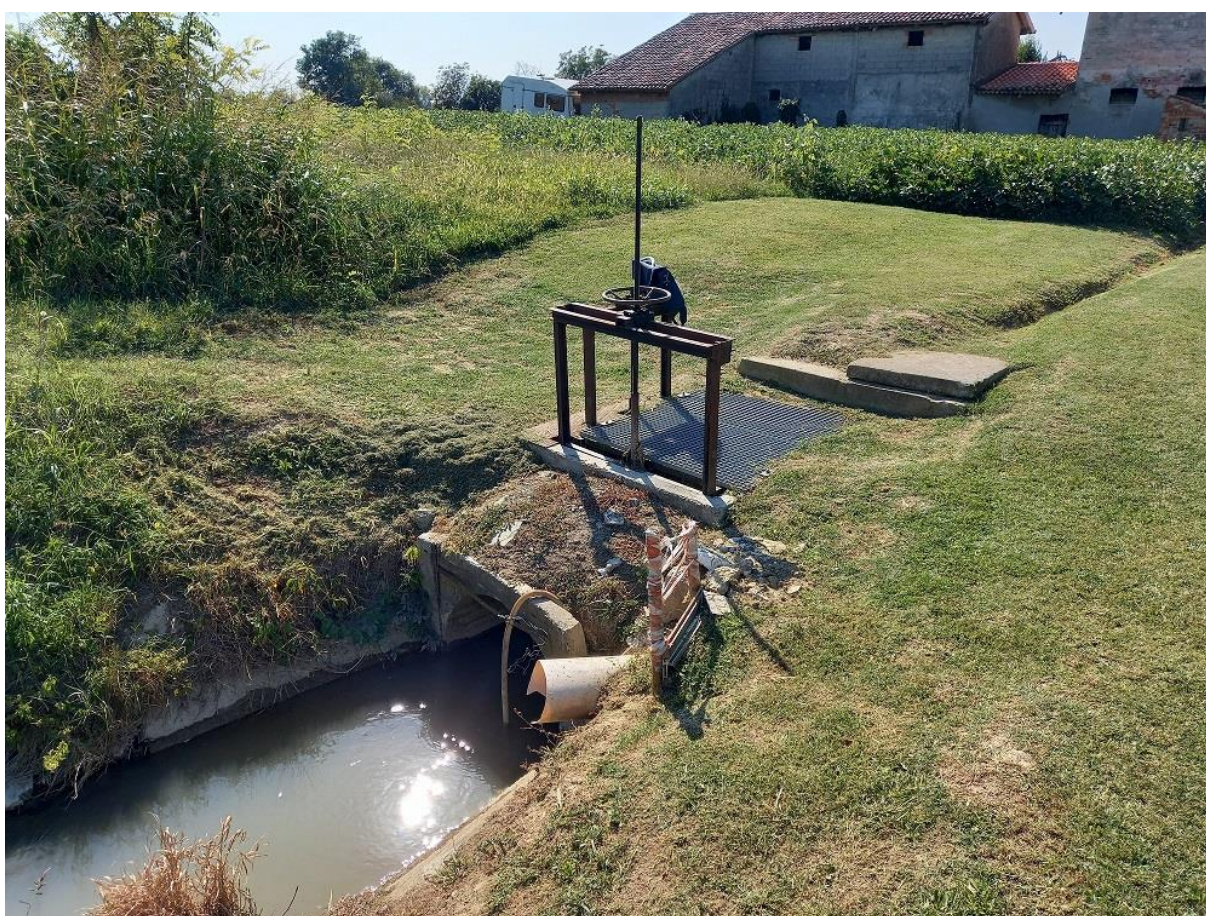
Manufatto di interclusione che permette il rigurgito delle acque derivate dal Dese per la pratica irrigua
