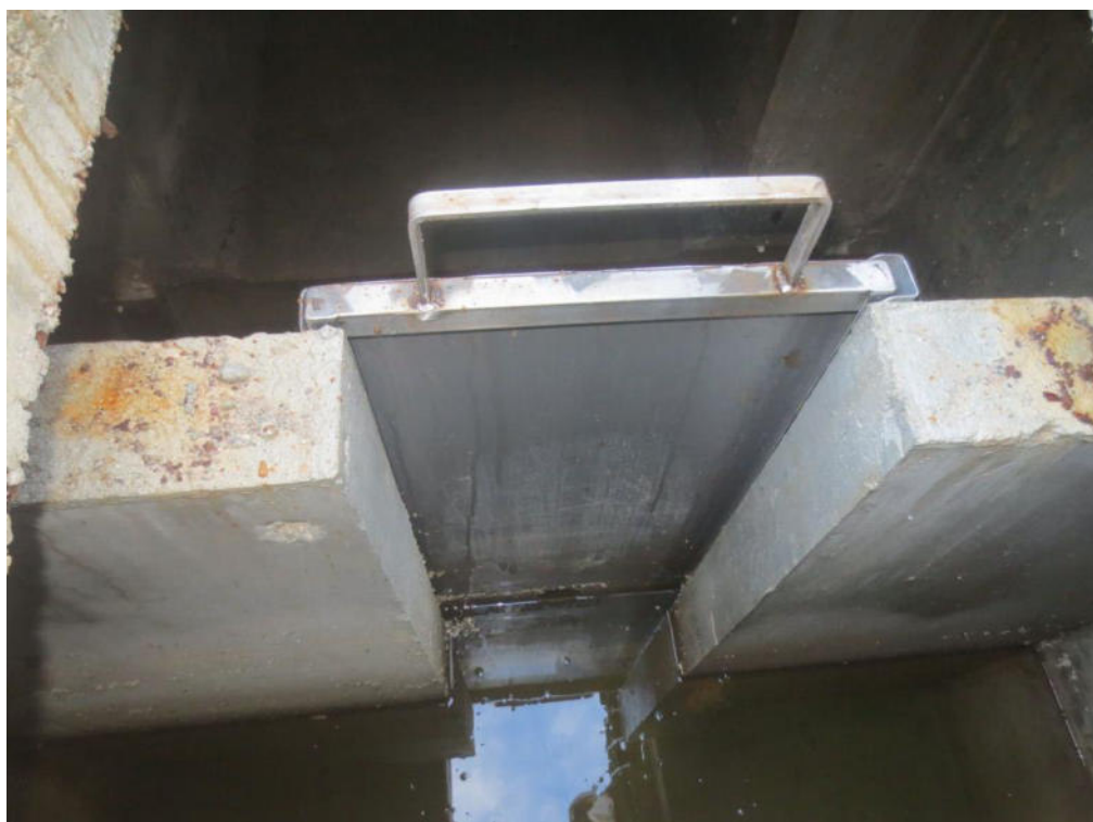
Figura 9: Alto=ovest: manufatto di controllo C2RS n° 101 (pozzetto A cono 09)
