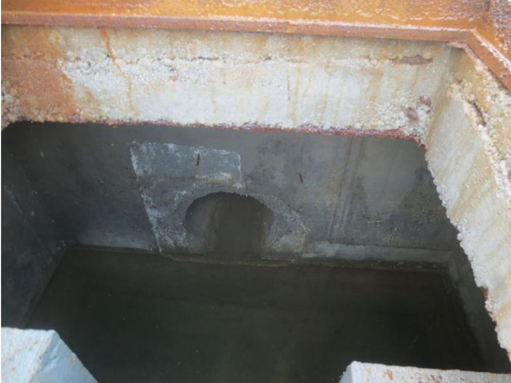
Figura 10: Alto=est: manufatto di controllo (pozzetto A cono 09)
